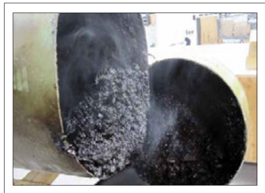
شکل شماره ۲. سیالات انتقال حرارت می توانند در جین استفاده اکسید شوند که منجر به خرابی زودرس می شود. در اینجا تصویر توده لجن ایجاد شده در یک منبع انبساط نمایش داده شده است.
